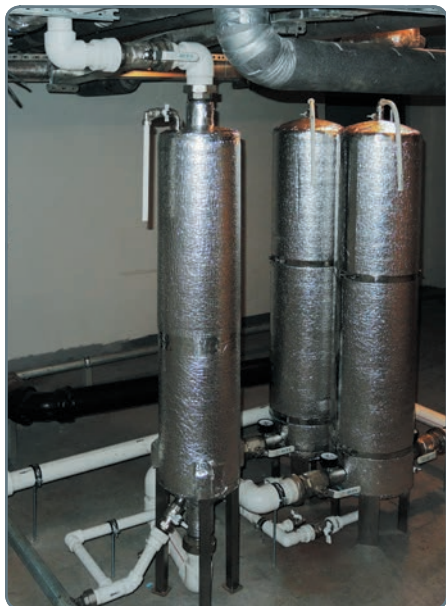
ОБЩИЙ ВИД ФИЛЬТРОВАЛЬНОЙ СТАНЦИИ, УСТАНОВЛЕННОЙ В ЖИЛОМ ДОМЕ
